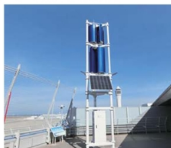
写真1. トルネード風力発電機
